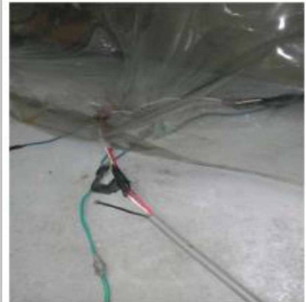
電源線與接地線接點以絕緣塑膠貼布接合，放置於地板，於清洗底板時易產生感電之危害。
