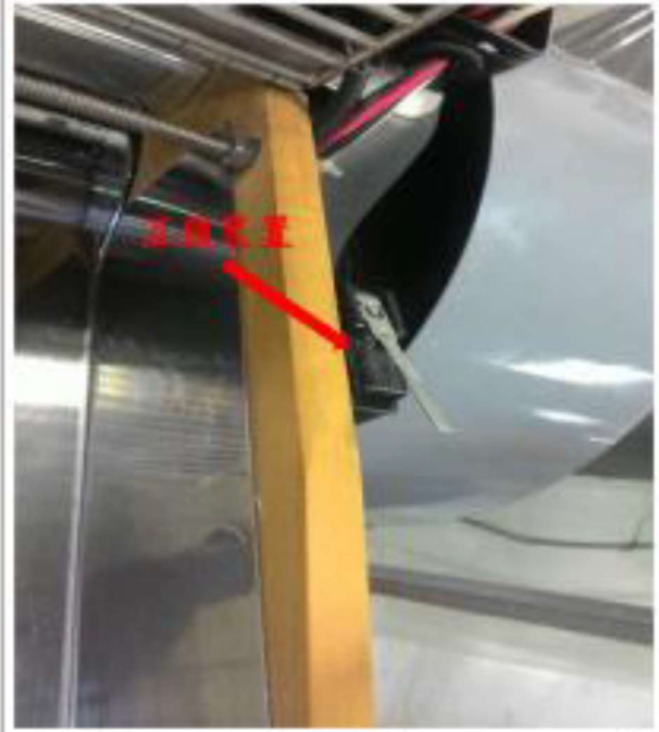
護罩下方設有互鎖裝置，功能正常
